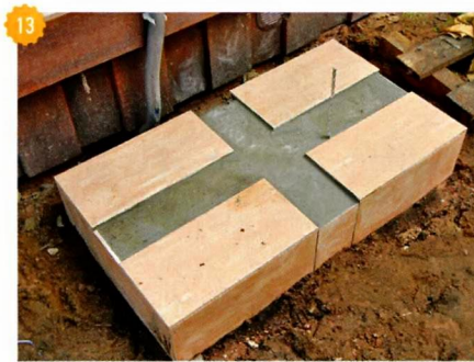
13 Фундамент для баллонов оклеили керамогранитом с широкими зазорами для вентиляции и вывели проводник заземления.
