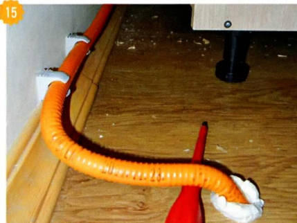
15 Ввод газопровода в дом и прокладка по стене. Использована сильфонная газовая труба Kofulso в полимерной оболочке.
